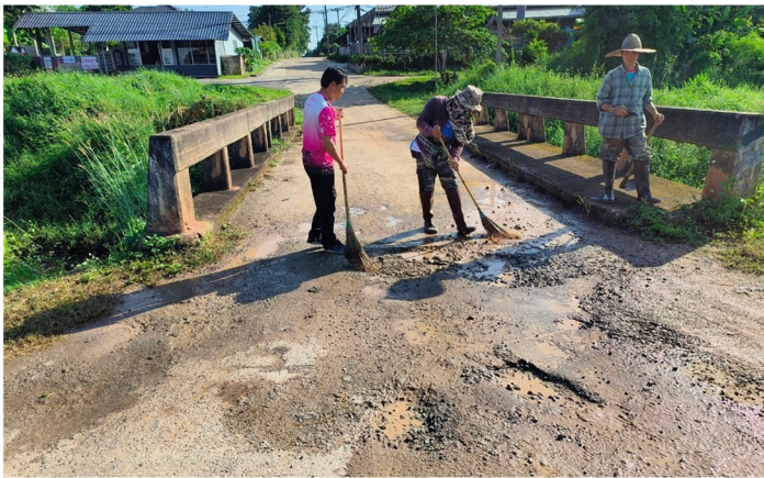
งานซ่อมแซมถนนที่เป็นหลุมเป็นบ่อ เสี่ยงต่อการเกิดอุบัติเหตุภายในชุมชน
